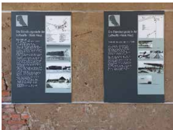
Fot. 105. Autorski komentarz nie zakrywa ubytków i zniszczeń (16.08.2025).
